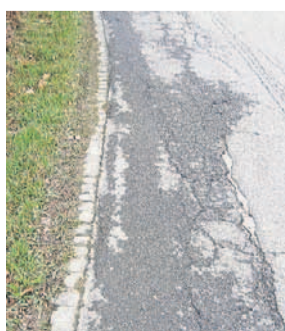
Die Sanierung ist überaus dringend.
